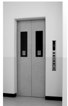
エレベーター
